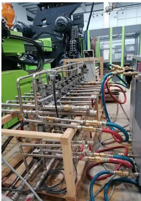
FIGURA 5 Segundo protótipo de sistema de controlo de arrefecimento em desenvolvimento pela DRT para ensaios em contexto real de injeção de plástico.
